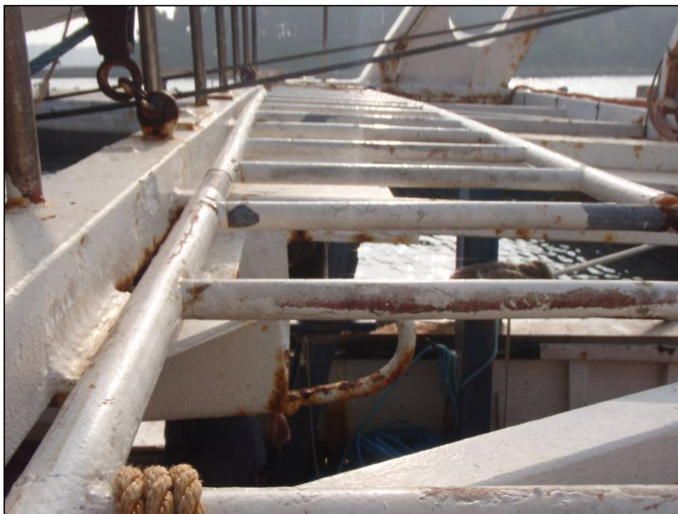
Slika 3 Mjesto naslanjanja teretnog-čelik čela na ljestve (naknadno izravnato)
