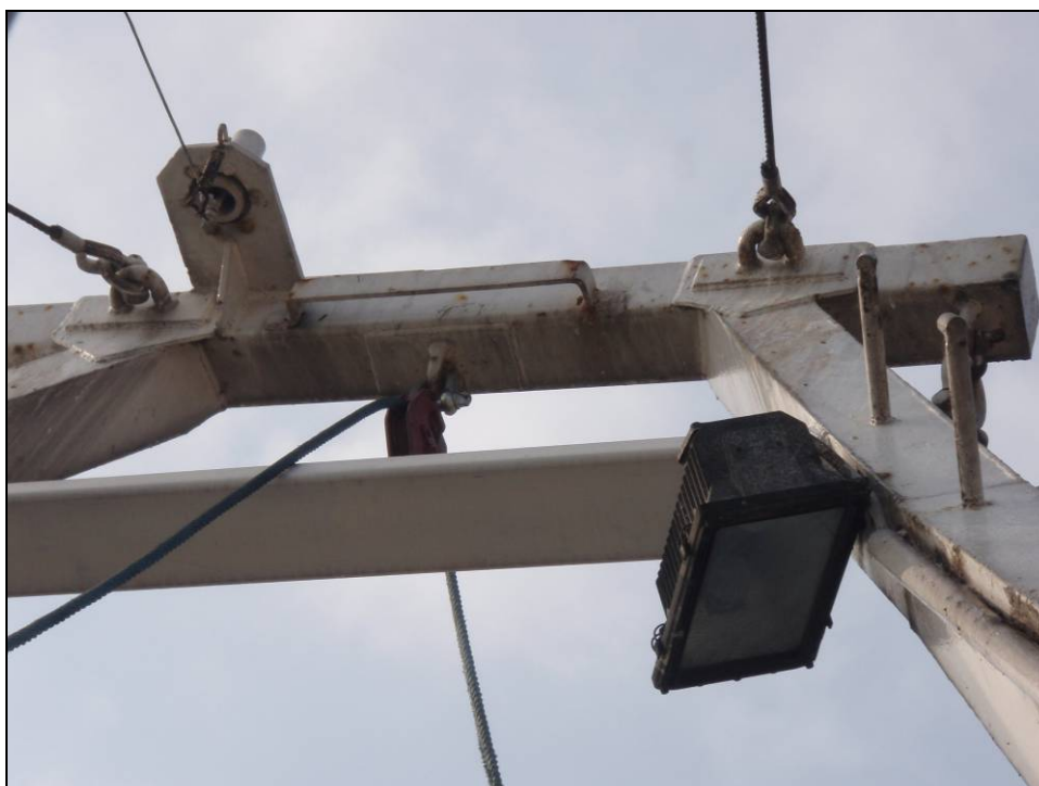
Slika 4 Koloturnik teretnog čelik-čela (poprečna greda je postavljena nakon nezgode)
